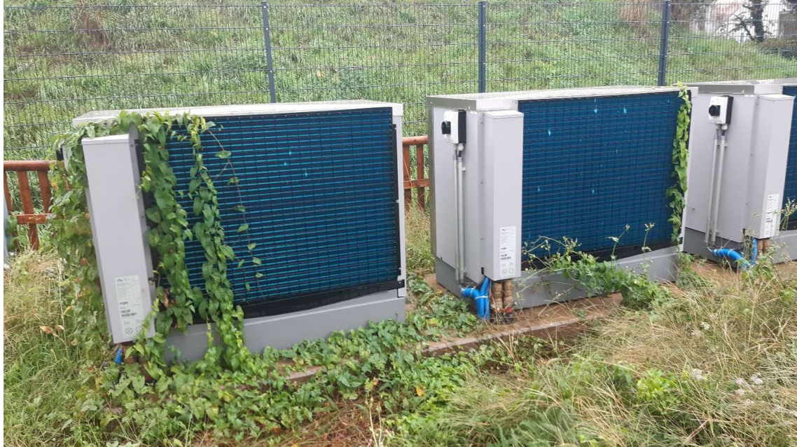
Abbildung 2: Wärmepumpe mit starkem Gartenbewuchs direkt am Luftwärmetauscher.
